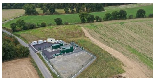
Le rebours mis en service
