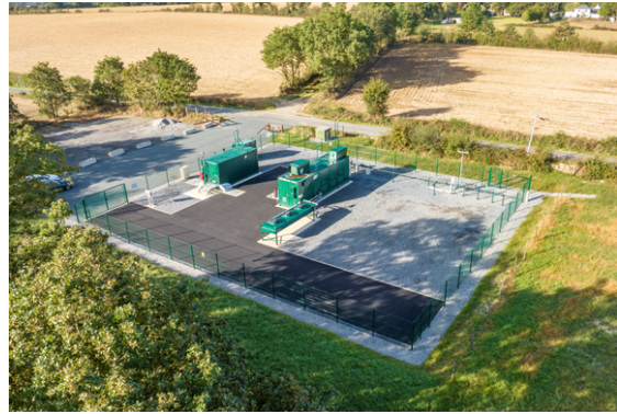
3 o poste de rebours à Saint-Aubin des Châteaux (44) mis en service en 2022
