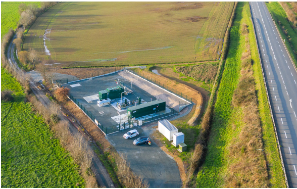
1 er poste de rebours des Pays de la Loire, à Pouzauges (85) mis en service en 2019
