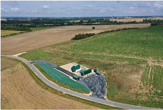
Poste de rebours de Marmagne , Cher (18), mis en service en 2021
